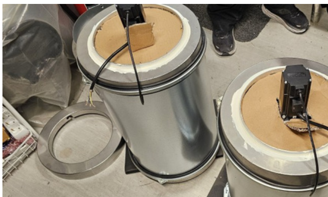
Lynx-enheter förberedda för installation med styrbox och anslutningskabel.
