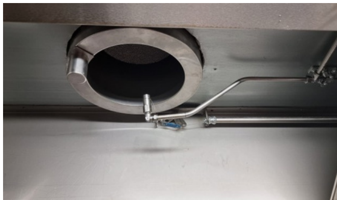
Öppning med monterad anslutningskrage och fettuppsamlingsanslutning ansluten i nederkant.
