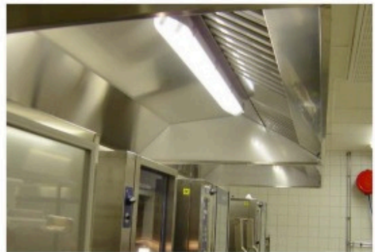
Filterhus i kåpa över ugn. Det är viktigt att överhänget är tillräckligt och att filterhuset monteras i framkanten av kåpan.
