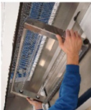
Ramarna med UV-lampor är lätta att demontera vid lampbyte
